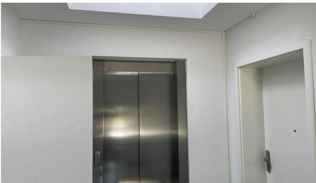
Abbildung 20: installierter Metallkanal in einem Treppenhaus (Quelle: DT)
