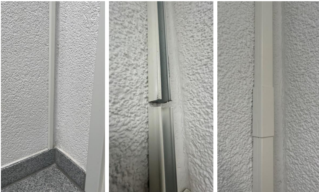
Abbildung 19: Metallkanal und Schnittkaschierung in einem Treppenhaus (Quelle: DT)
