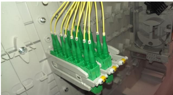
Abbildung 43: Beispiel einer übersichtlichen Steckerablage im Glasfaser-Gebäudeverteiler (Gf-GV) (Quelle: DT)
